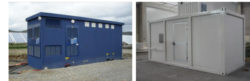
Exemples d'onduleurs et transformateur installés dans postes béton et containers
